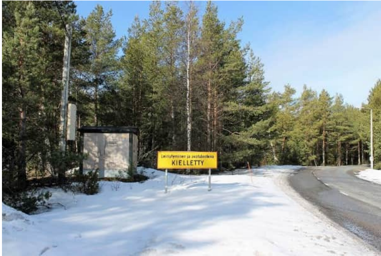
Kuva 13. Muuntamorakennus sijaitsee sisääntulotien läheisyydessä epävirallisen parkkipaikan reunalla.
